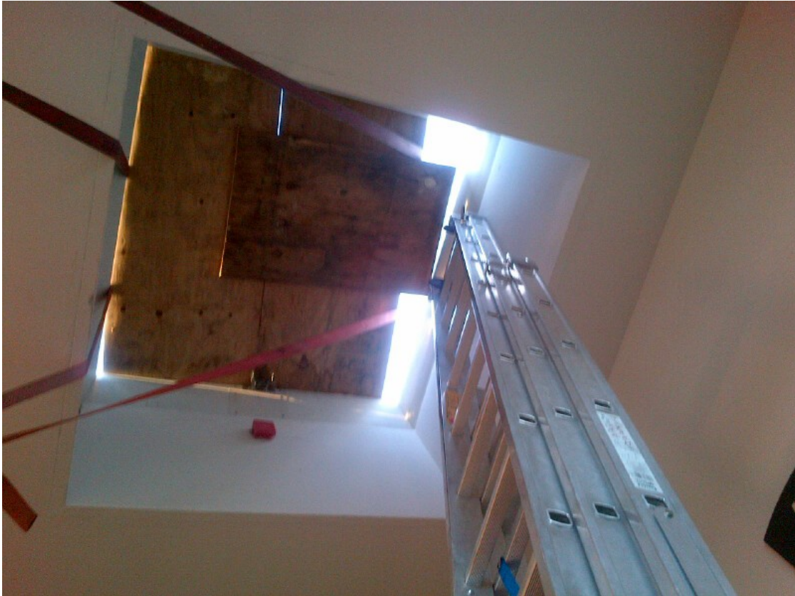
Abbildung 1: Sturmschaden an einer Dachluke
