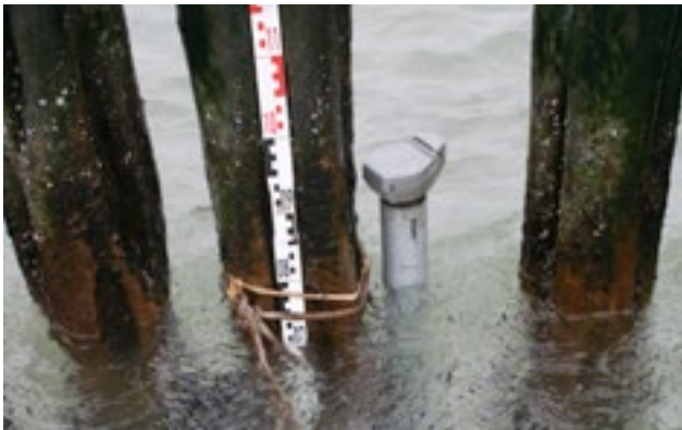
1.54 > Detail der neu errichteten Messstelle 4. Die ursprüngliche Messstelle ist vermutlich durch Wellenschlag zerstört worden
